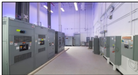
Figura 1. 17 Conexiones entre tableros de distribuciones
