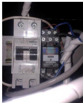
Figura 2.56 Relé e interruptor montados en el banco Fuente: Autores
