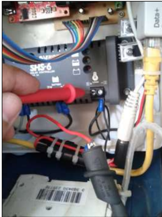
Figura 71. Medición de corriente y voltaje de la carga.
