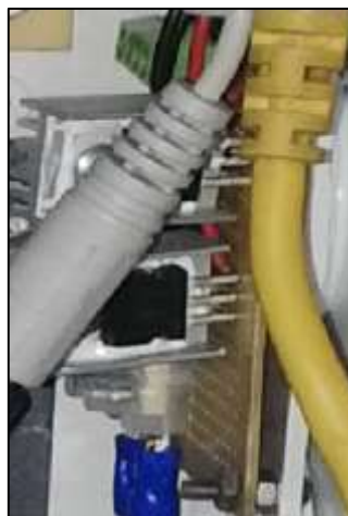
Figura 46. Colocación del regulador de voltaje para la alimentación de las tarjetas wiz110sr y meteoro-ups.
