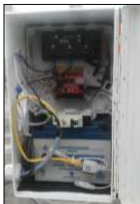
Figura 69. Colocación de la batería recargable y cableado de los sensores.
