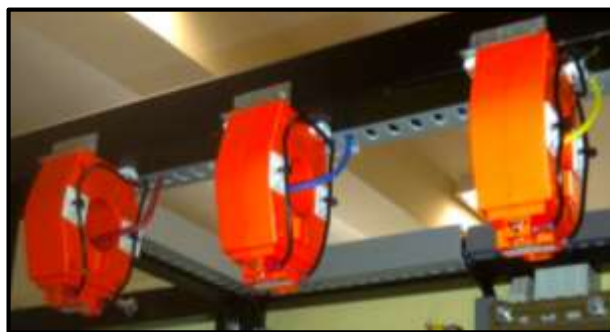
Ilustración 81 Transformador de corriente
