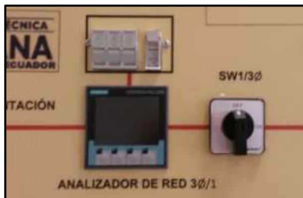
Ilustración 25 Medidor de energía
