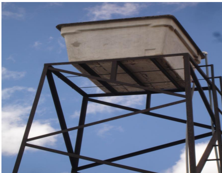
FOTO 1. 10■ tanque de suministro de agua tratada
