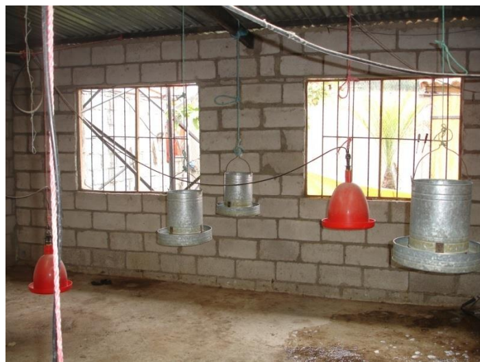
FOTO 1. 3 ■ ventilación para el galpón sección 2
