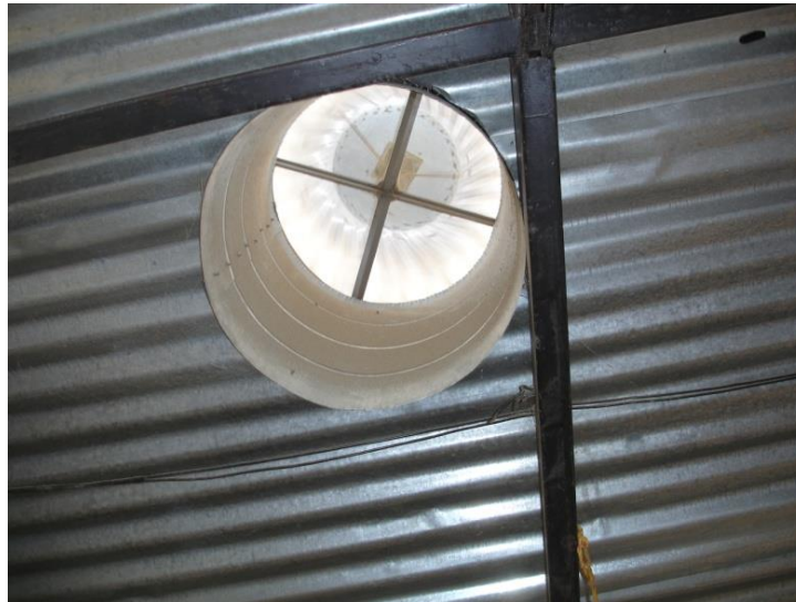
FOTO 1. 1 ■ ventilación para el galpón sección 1
