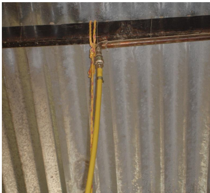
FOTO 1. 13■ distribución de gas para las criadoras
