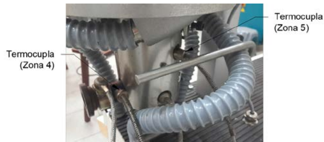
Figura 6: Conexión de Termocuplas
