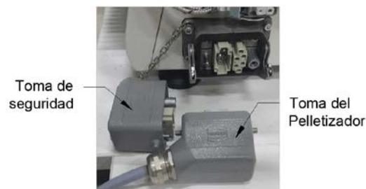
Figura 12: Conexión Pelletizador "CSG 171T"
