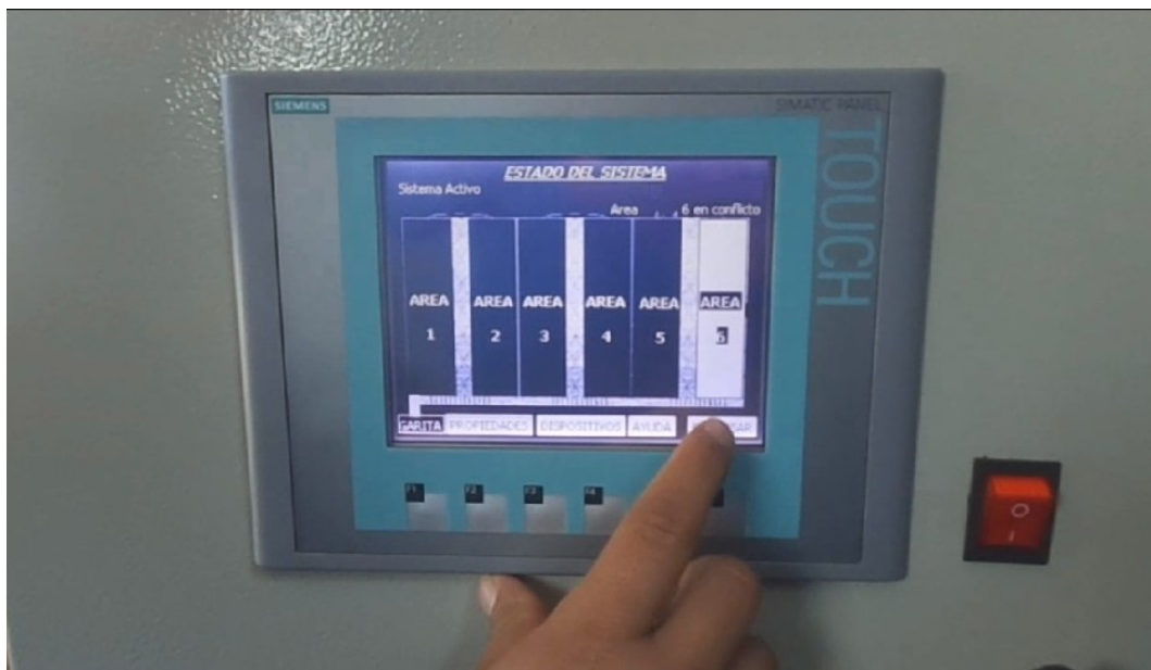
Figura 74: Estado alarma área 6
