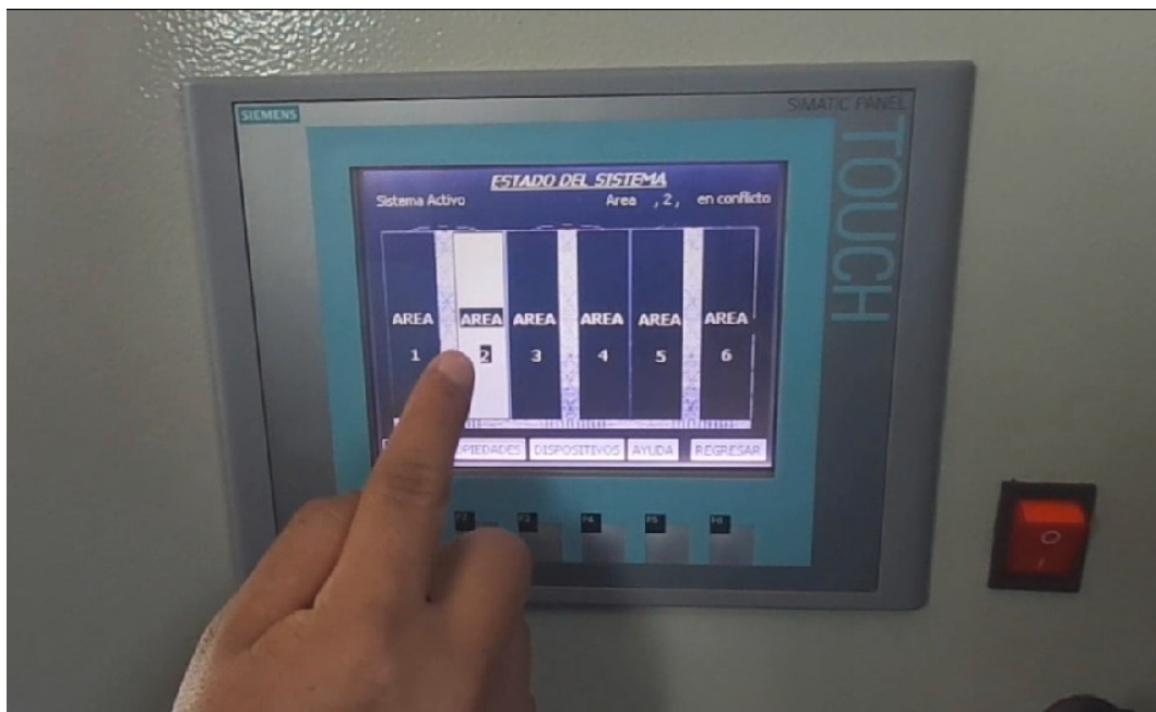
Figura 68: Estado alarma área 2
