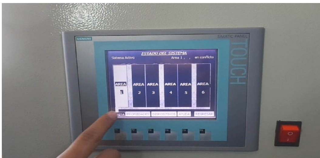
Figura 67: Estado alarma área 1
