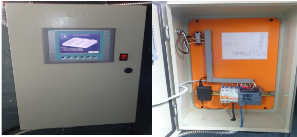
Figura 62: PLC S7 1200 y KTP 600 instalados
