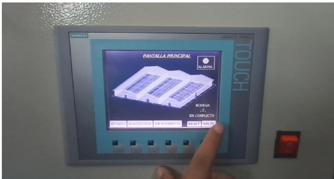
Figura 69: Pantalla principal estado alarma bodega 2
