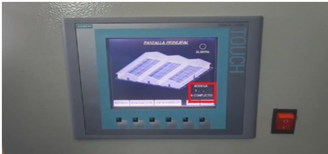
Figura 66: Pantalla principal estado alarma bodega 1
