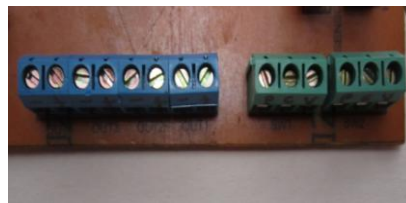
Figura 61. Salidas de los Variadores y Entradas de Control Automático y Manual
