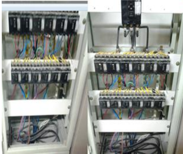
Figura 87.45 Instalaciones Laboratorio de Instalaciones Civiles Fuente: Los Autores
