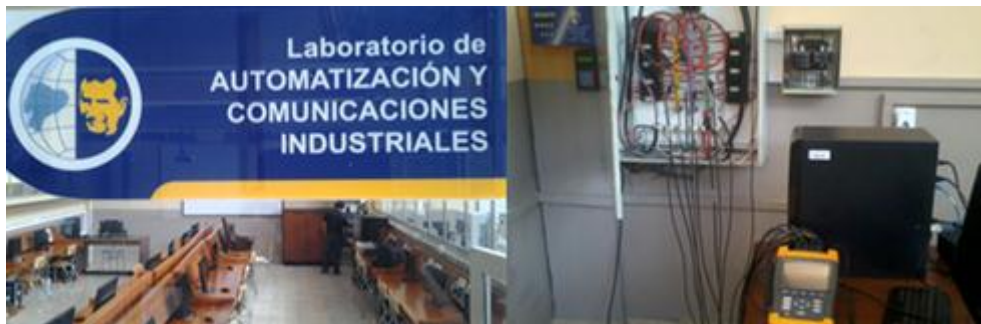
Figura 76.34 Automatización y Comunicaciones Industriales
