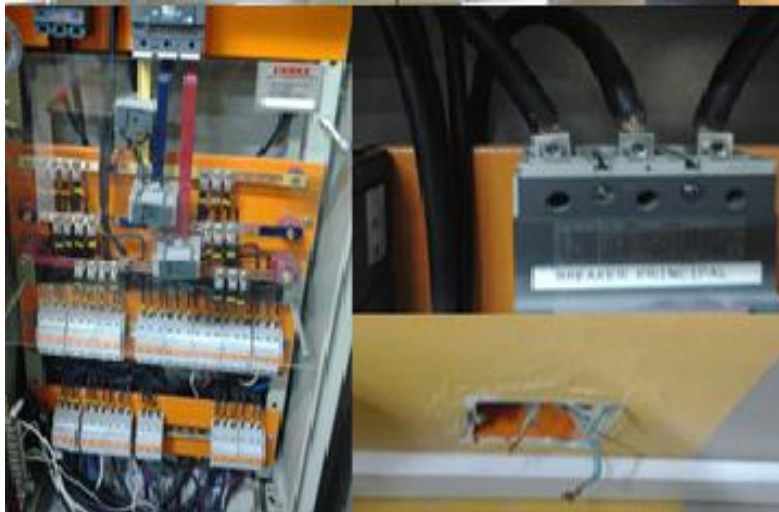
Figura 71.29 Instalaciones Laboratorio Investigación y Proyectos Fuente: Los Autores
