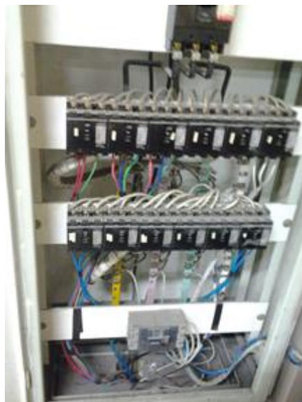
Figura 95.53 Instalaciones Laboratorio de Electromagnetismo Fuente: Los Autores
