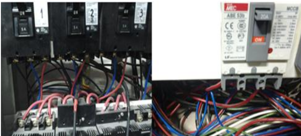
Figura 56.14 Instalaciones Laboratorio de Monitoreo y Control Fuente: Los Autores
