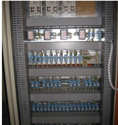
Fig. 4.9 Adecuada disposición de cables y canaletas dentro de los tableros con marquillas correctamente colocadas. 4
