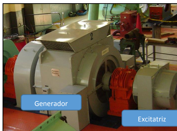
Fig. 1.9 Disposición del generador de 8MW en la central Saucay. (Fuente Propia)
