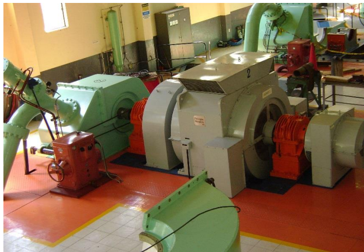
Fig. 4.7 Correcta disposición del generador síncrono de eje horizontal, con sus componentes debidamente pintados con distintos colores de acuerdo a los patrones de instalación para centrales hidroeléctricas. 3
