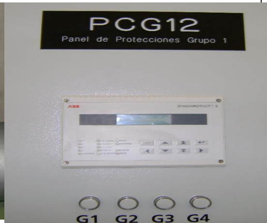
Fig. 4.11 Correcto etiquetado de los tableros. 4
