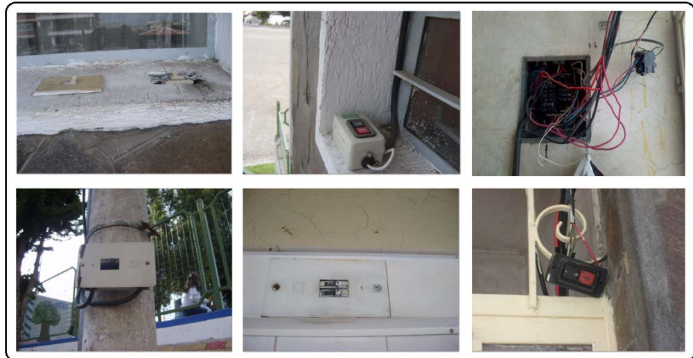
Fig. 2.61 Estado del Sistema Eléctrico de Iluminación 150
