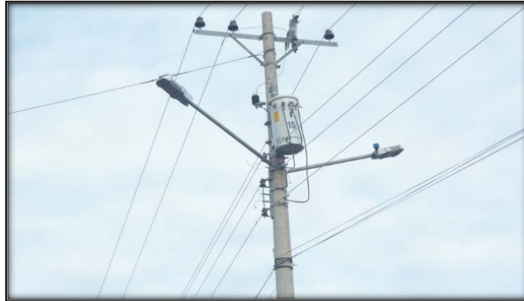
Fig. 1.5. Poste de Cemento armado 5
