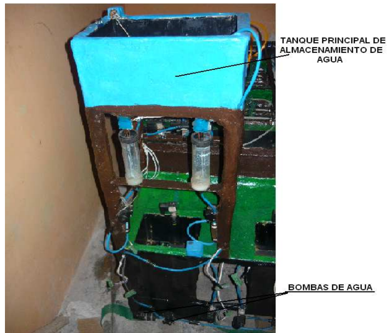
FIGURA 2.45 TANQUE PRINCIPAL DE ALMACENAMIENTO DE AGUA FUENTE: LOS AUTORES
