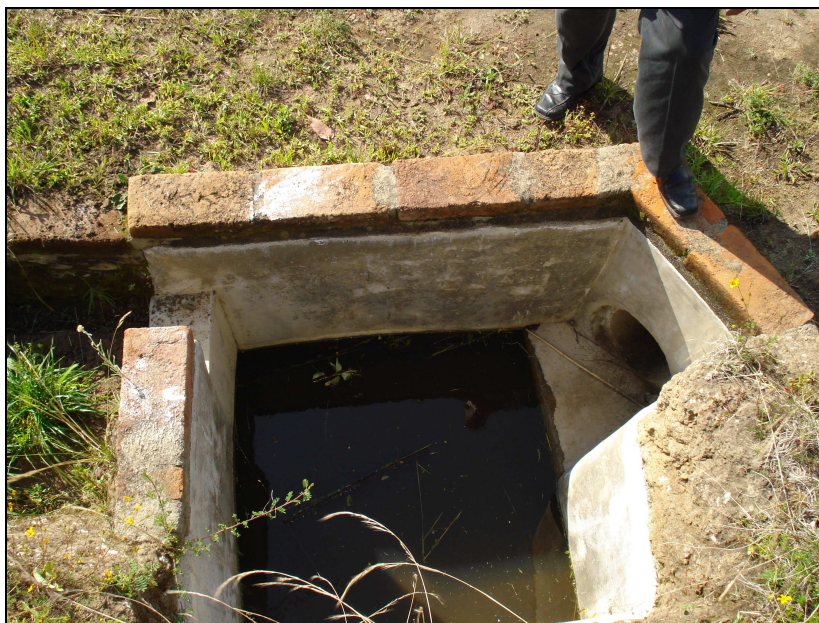
FIGURA 1.28 POZO, PROYECTO ECOLOGICO PACAILOMA TUMBACO. FUENTE: LOS AUTORES
