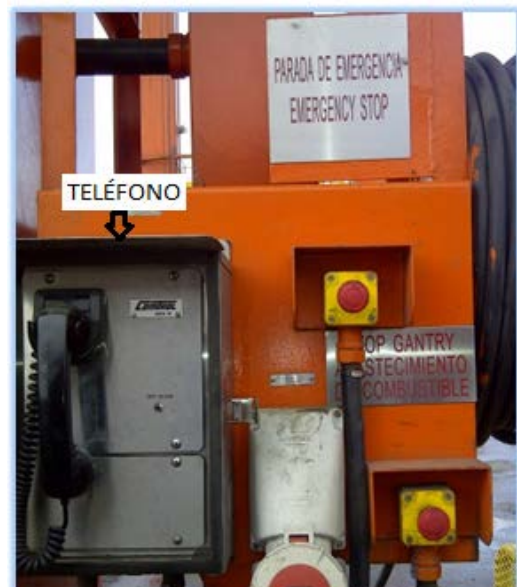
Foto 2.12: Parada de Emergencia
