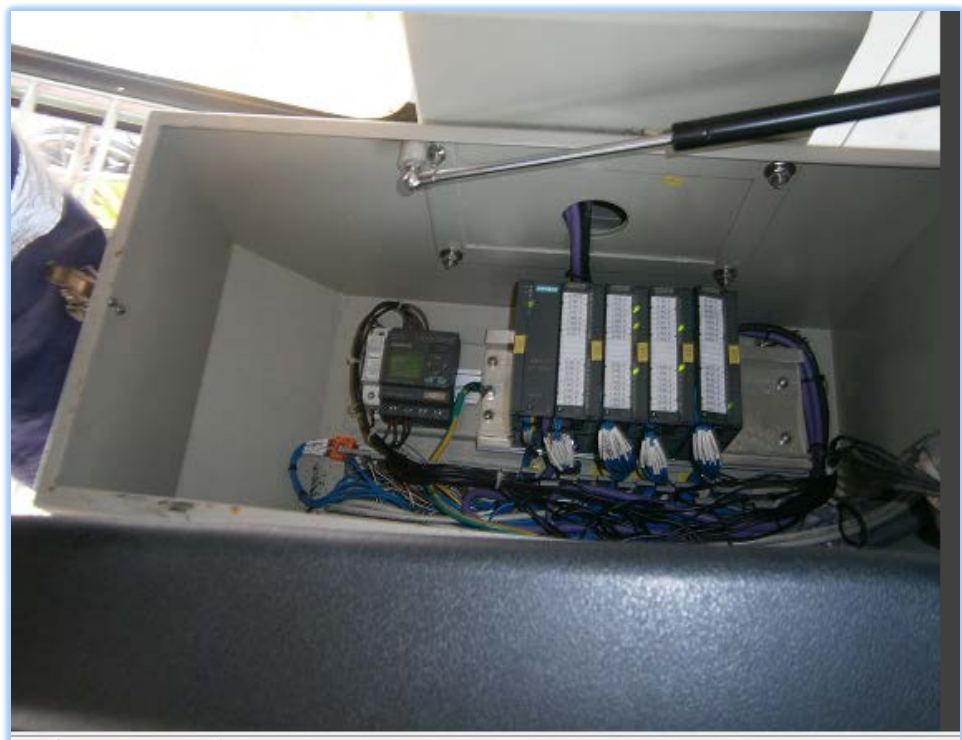
Foto4.6: Instalación del LOGO en consola del Operador
