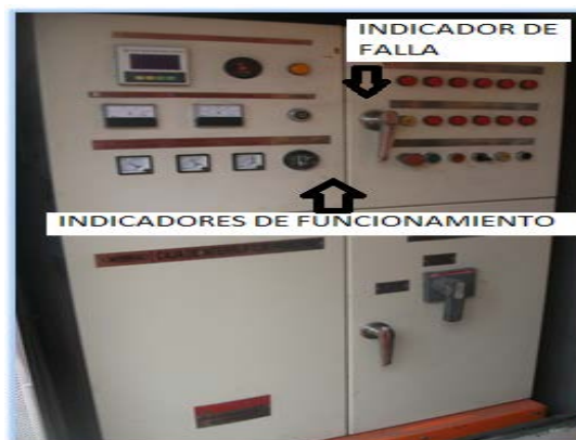
Foto 2.26: Tablero de control de presión, aceite, frecuencia.
