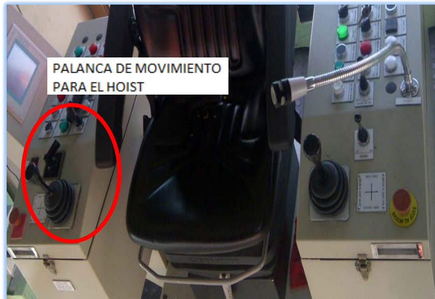
Foto 2.5: Vista del Cuarto del Operador con sus Joystick y consola.
