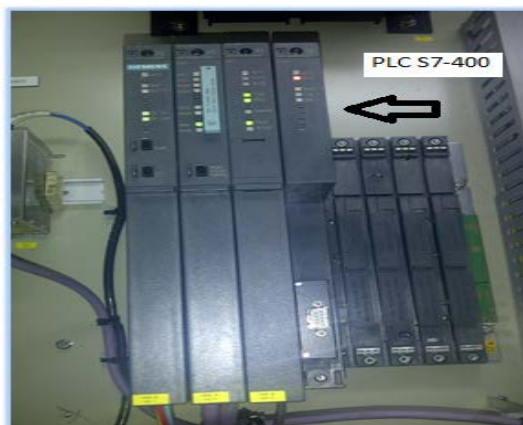
Foto 2.24: Imagen del PLC S7-400
