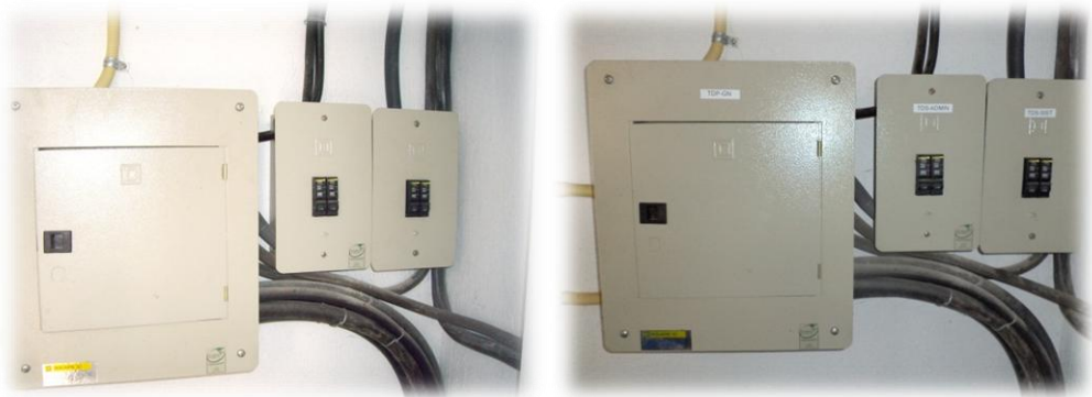
IMPLEMENTACIÓN tablero de distribución secundario y etiquetado final.
