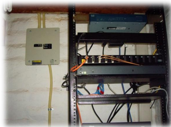
IMPLEMENTACIÓN FINAL TDS-SISTEMAS.
