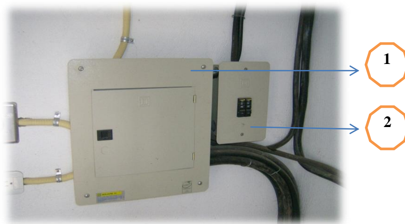
FIG.34. FOTO ANTES DE LA IMPLEMENTACIÓN, SUBTABLERO DE DISTRIBUCIÓN.
