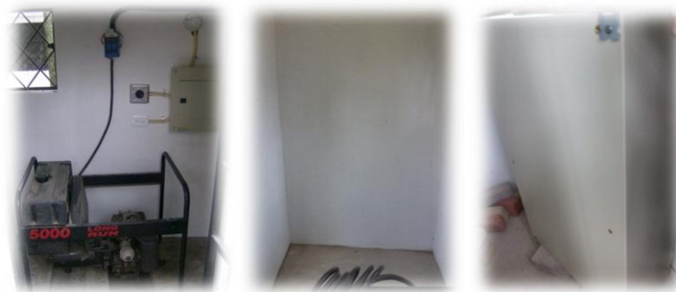
Implementación , montaje Módulo de transferencia.
