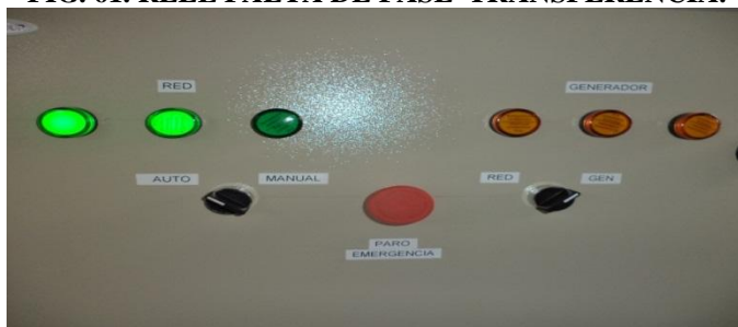
FIG. 62. PARTE FRONTAL TABLERO DE TRANSFERENCIA ENCENDIDO.
