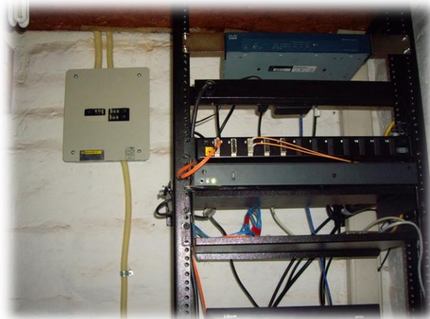
FIG. 38. IMPLEMENTACIÓN FINAL SUBTABLERO DE DISTRIBUCIÓN SISTEMAS.
