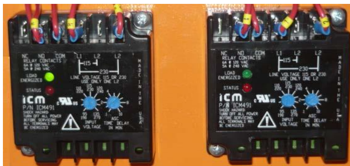
FIG. 61. RELÉ FALTA DE FASE TRANSFERENCIA.
