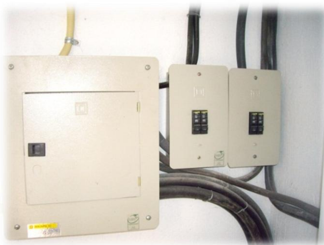
FIG.39. TABLEROS DE DISTRIBUCIÓN SIN ETIQUETAR.
