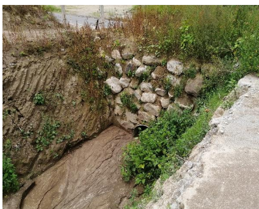
Entrada de alcantarilla taponada 50%
