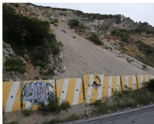
Muro en estado regular – malo
