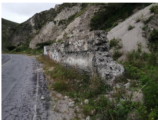
Muro en estado malo
