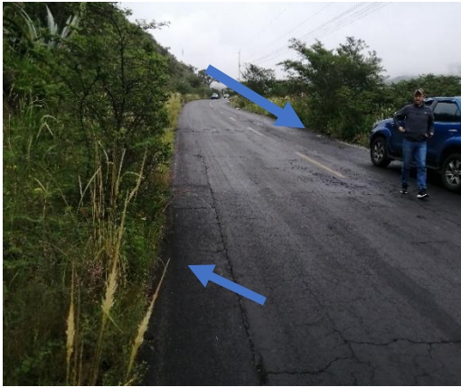
No existe marcas de pavimento laterales
