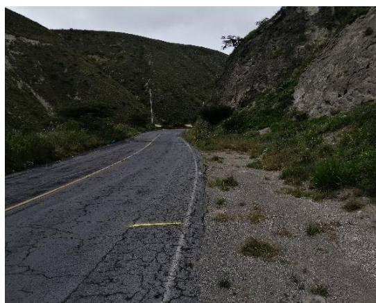
No existe cuneta
