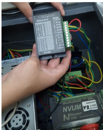
Figura 31. Tablero original del robot 4GDL
