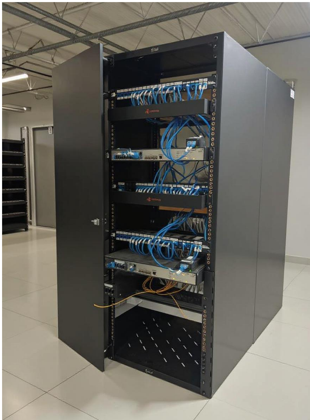
Figura 35 – Datacenter ubicado en Megamaxi Ceibos Fuente: Autor.
