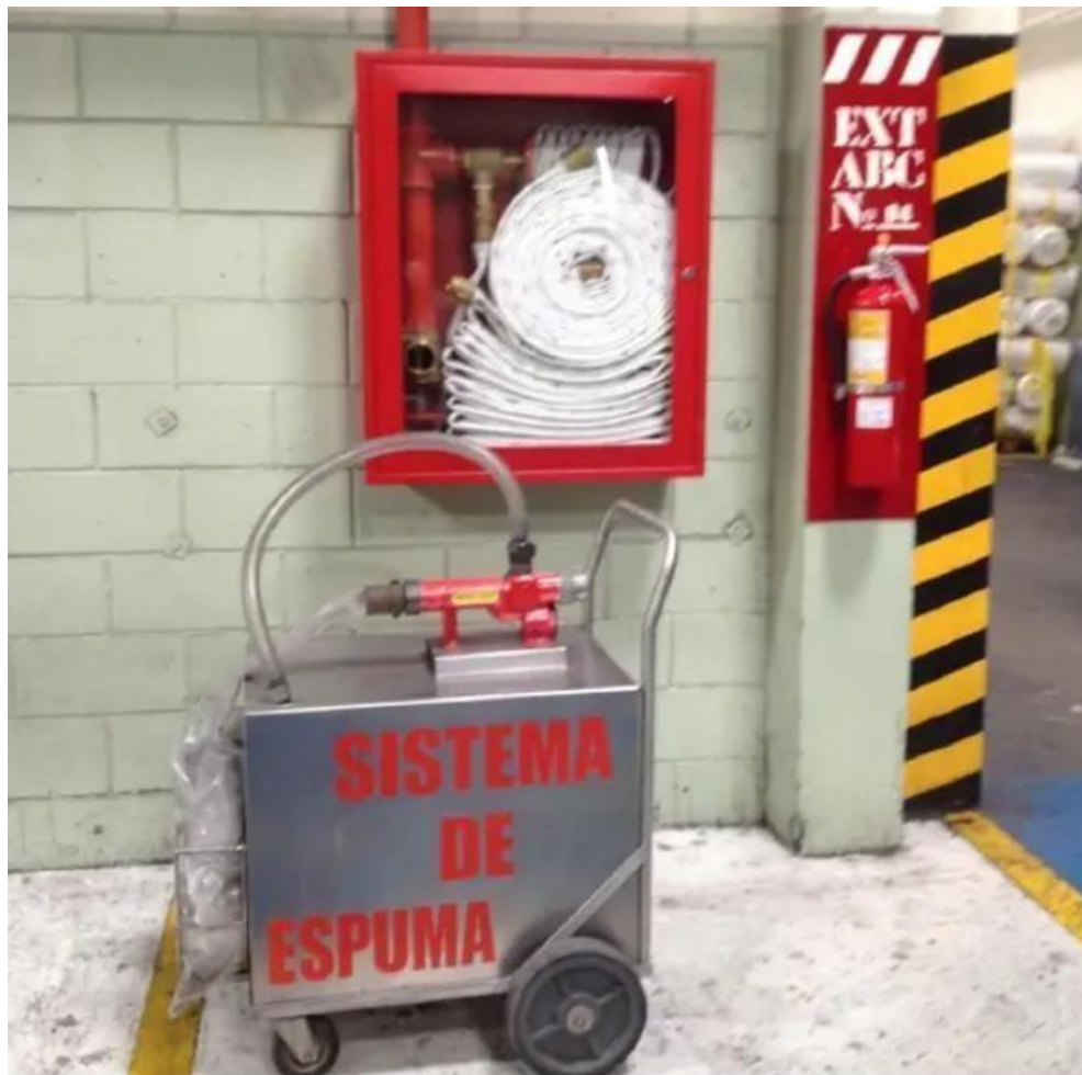
Ilustración 10 - Sistema De Extintor Y Espuma
