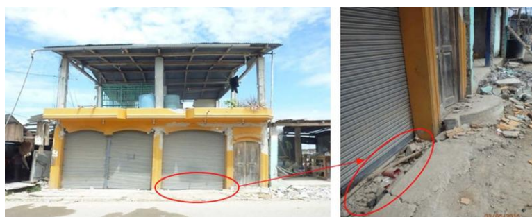
Figura 18 Asentamiento y desplazamiento diferencial en estructura
