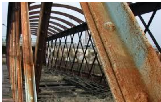
Figura 12 Corrosión en las estructuras de acero
