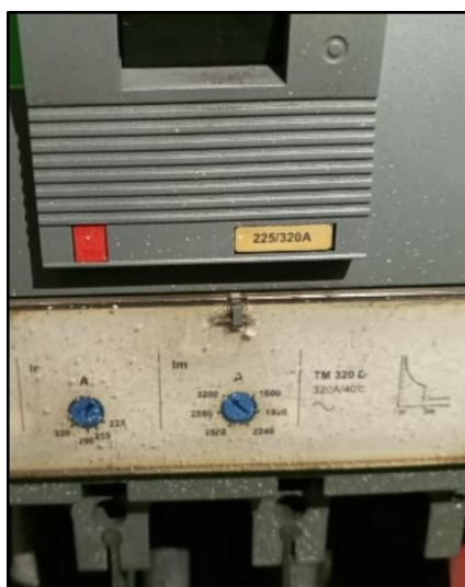
Figura 32. Datos del disyuntor de la Carga.
