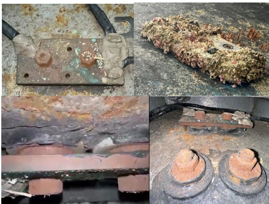
Figura 19. Conexión entre bonding bus bar y ánodo de sacrificio.
