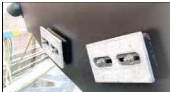
Figura 10. Grounding, protección catódica.
