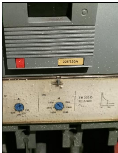
Figura 22. Datos del disyuntor del Generador.
