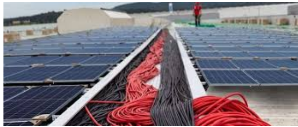
Figura 1.8: Cableado electrónico en la instalación fotovoltaica [5].
