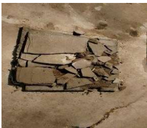
ruptura de modulo
