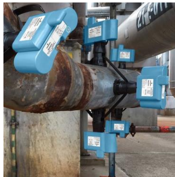
Figura 6. Monitorización de la corrosión y erosión [16].
