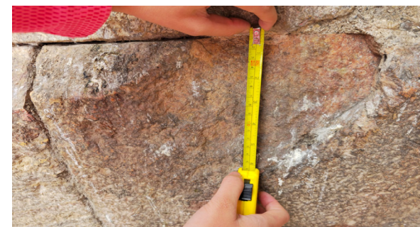
Fotografías: Paredes exteriores, bordes inferiores de muros y mediciones de pérdida de material. Fuente: Elaboración propia.
