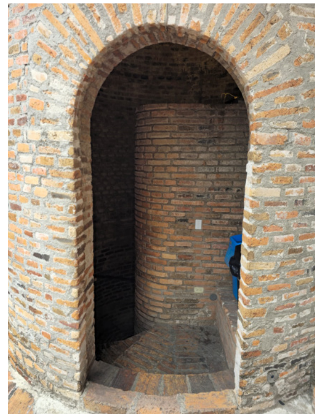
Fotografía: Cableado eléctrico expuesto, numeración de gradas, desgaste de bordes y paramentos Fuente: Elaboración propia.
