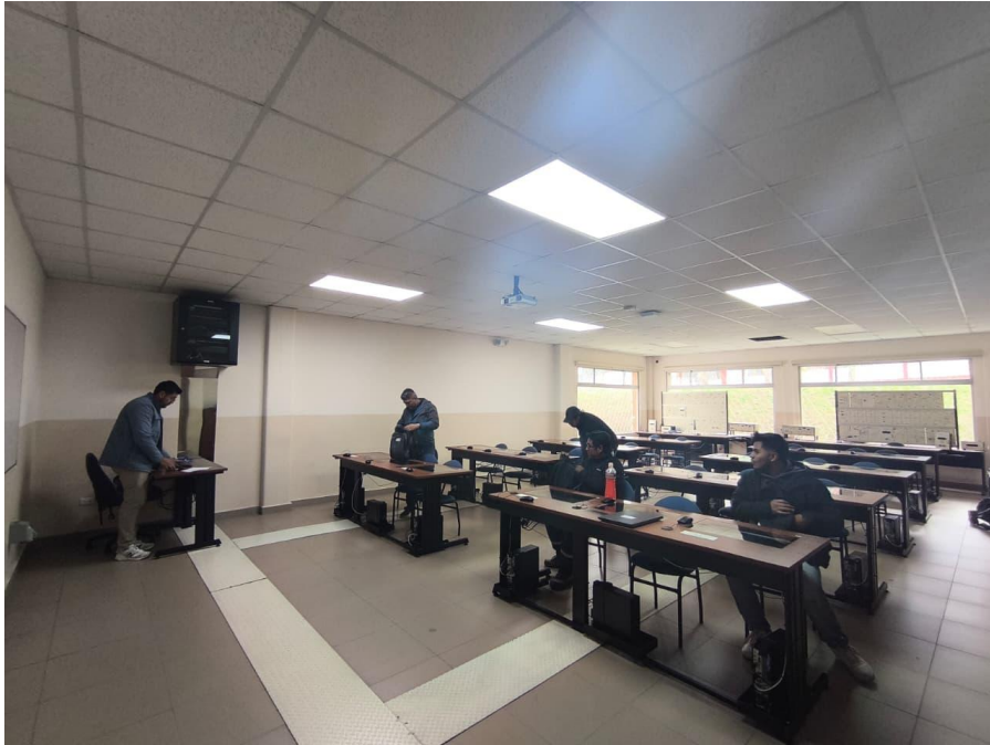
10. AULA CON LUMINARIAS LED 18W
