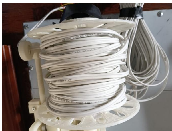
Figura 76. Cable excediendo la capacidad de las aletas del carrete.
