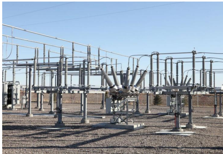
Figura 5. Interruptores de potencia Fuente: [19]
