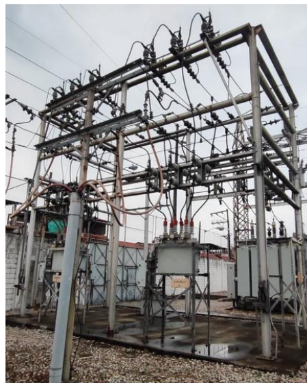
Figura 3 Re-conectores y Bahía de 13.8 kV, Subestación Padre Canales
