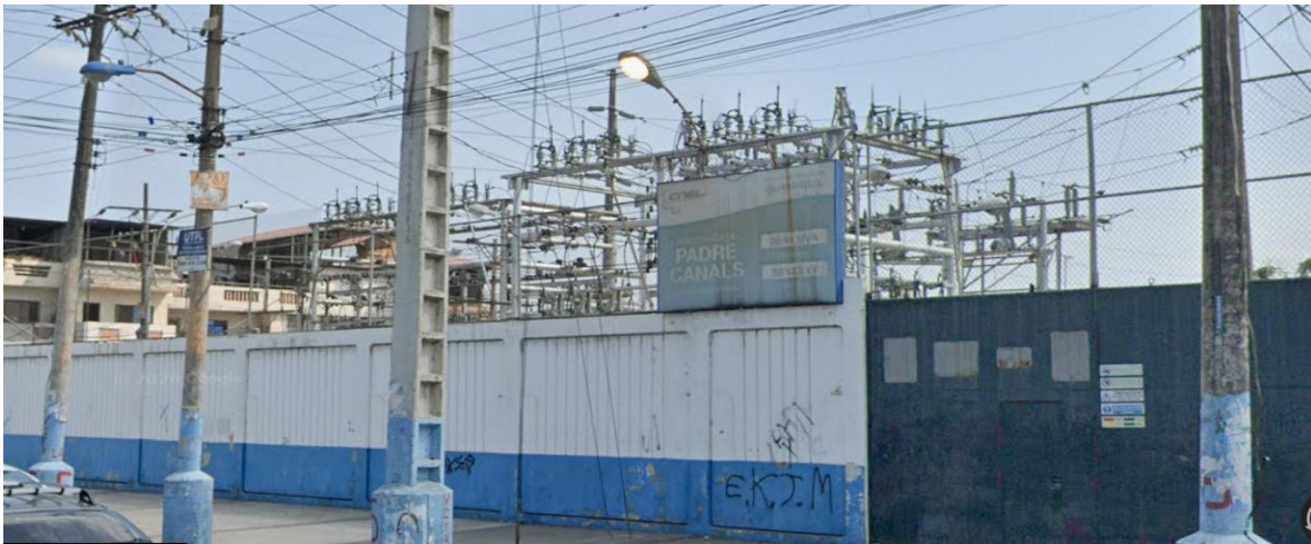
Figura 1 Foto de la Subestación Padre Canales
