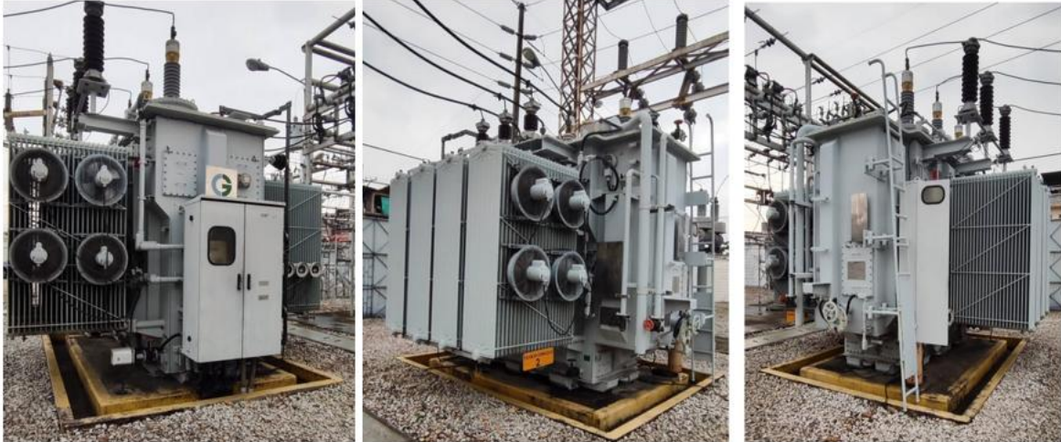
Figura 5 Transformador de Poder, Subestación Padre Canales
