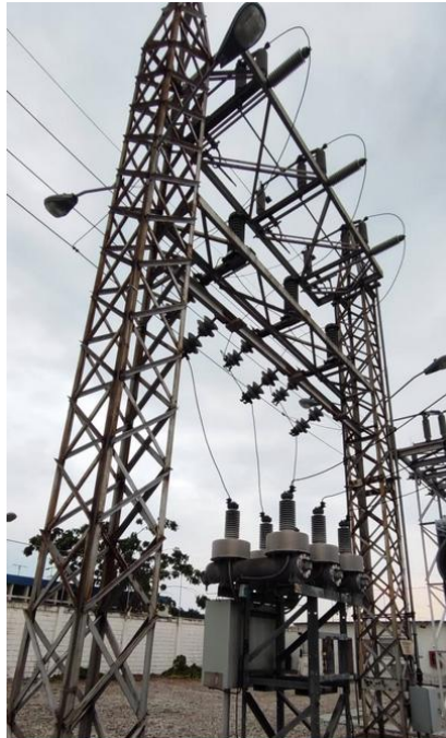
Figura 4 Bahía de 69 kV, Subestación Padre Canales
