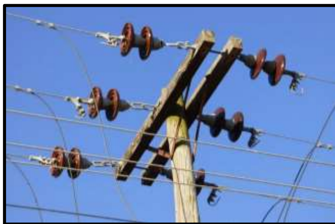
Figura 2.3. Aisladores en sistema eléctrico
