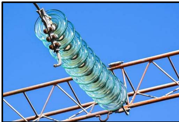
Figura 2.5. Aisladores de vidrio
