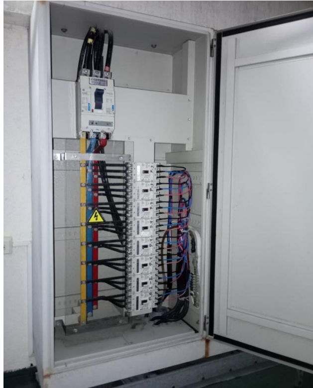
Figura 7 Tablero de distribución trifásico
