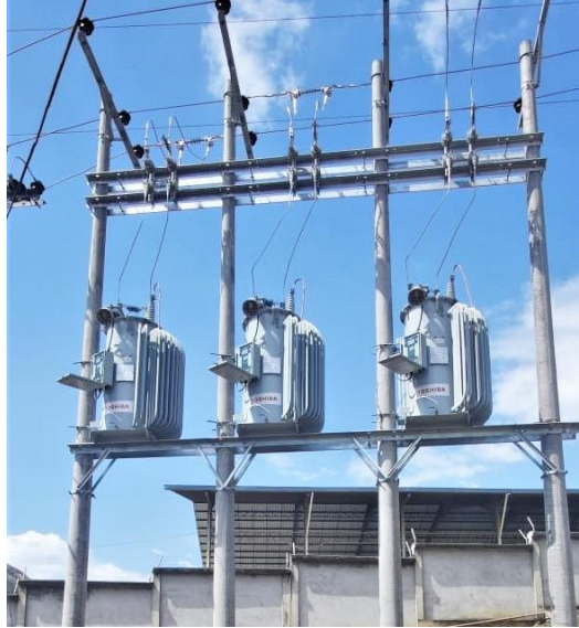
Figura 5 Reguladores de voltaje monofásicos
