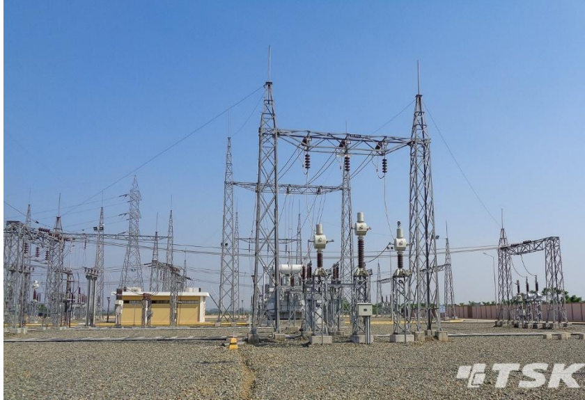
Figura 7 subestación “Nuevo Babahoyo”[12]
