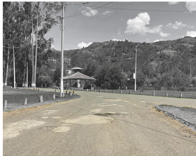
05. Deterioro de vía frontal
