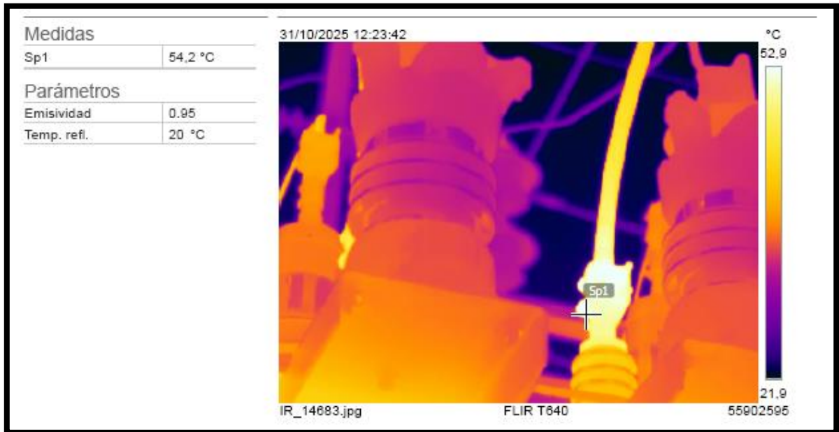
Figura 6. Transformador de Potencia
