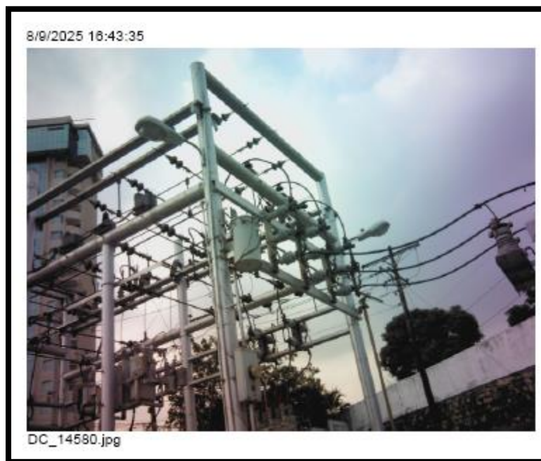
Figura 7. Seccionador Principal de Media Tensión
