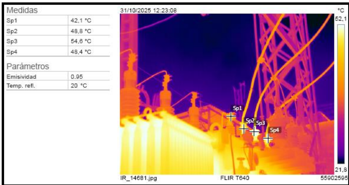
Figura 5. Termografía de Puntos Calientes
