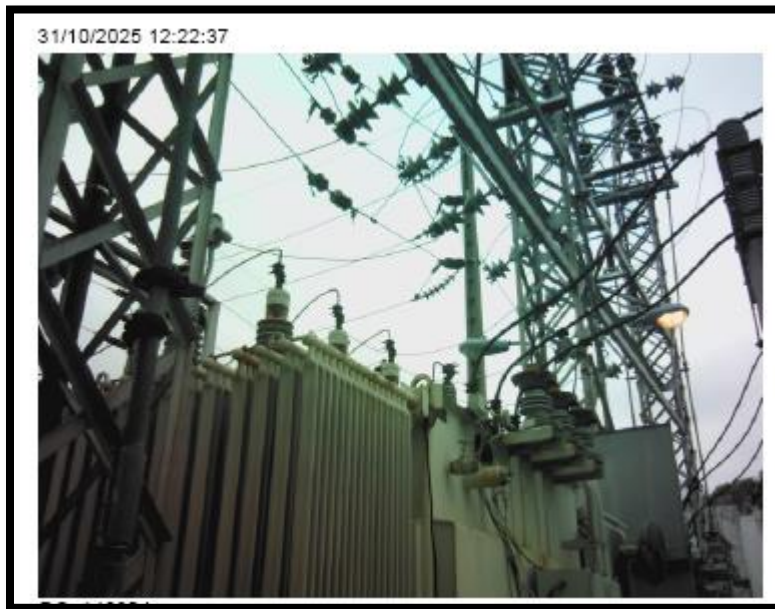
Figura 4. Transformador de Potencia
