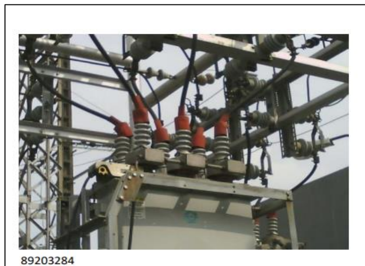
Figura 9. Reconectador de Media Tensión
