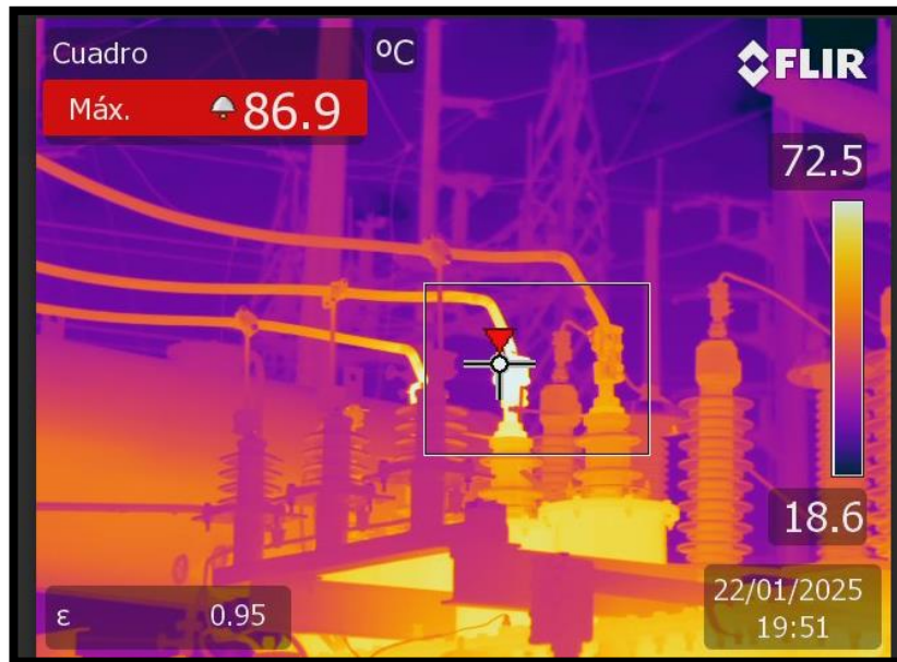
Figura 18. Transformador De Poder Con Alta Temperatura En Terminales De Bushing
