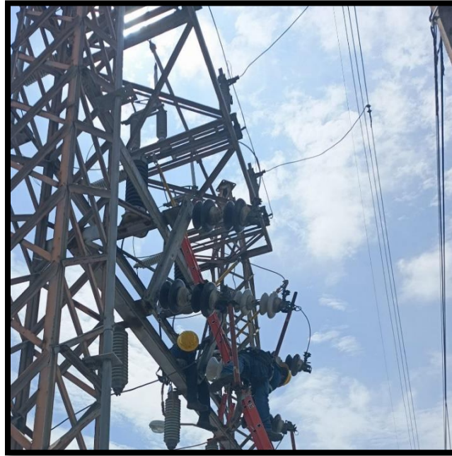
Figura 11. Mantenimiento Predictivo En Subestaciones Eléctrica
