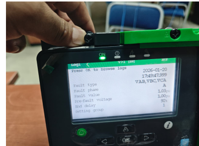
(c) Registro del evento de sobrevoltaje
