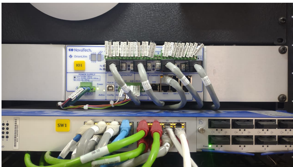
Figura 3.30: Conexiones físicas: IEDs, RTU, switch y computadora.
