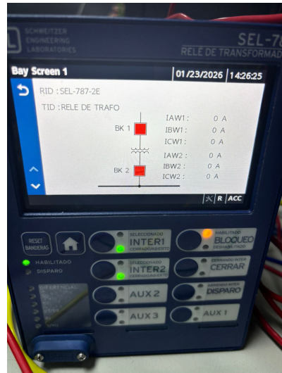
Figura 4.11: Vista de los interruptores en estado abierto desde el IED 787.
