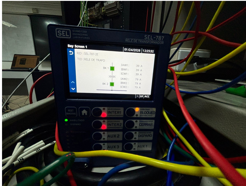
Figura 4.12: Vista de los interruptores en estado cerrado desde el IED 787.
