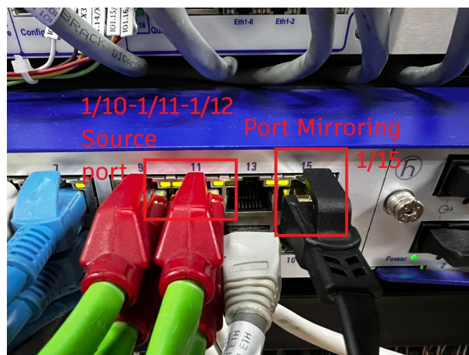
Figura 5.25: Detalle de los puertos asignados a los IEDs a supervisar.
