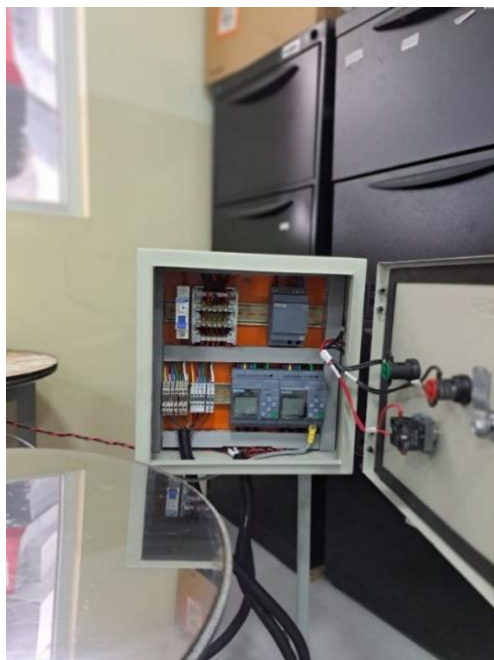
Figura 38. Tablero de Control Planta
