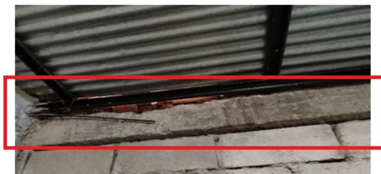
Ilustración 53 Viga hormigón pobre
