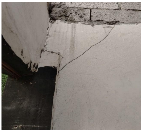
Ilustración 30 Fisura no estructural
