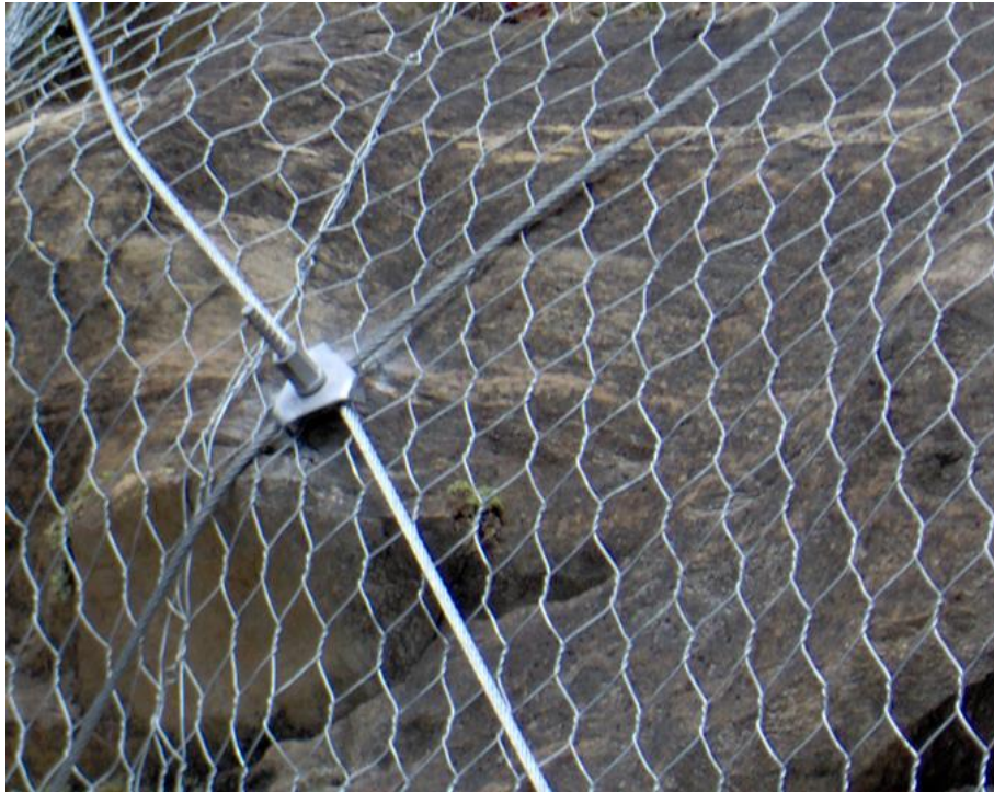
Figura 33 Aplicación de malla de triple torsión en taludes para control de caída de rocas
