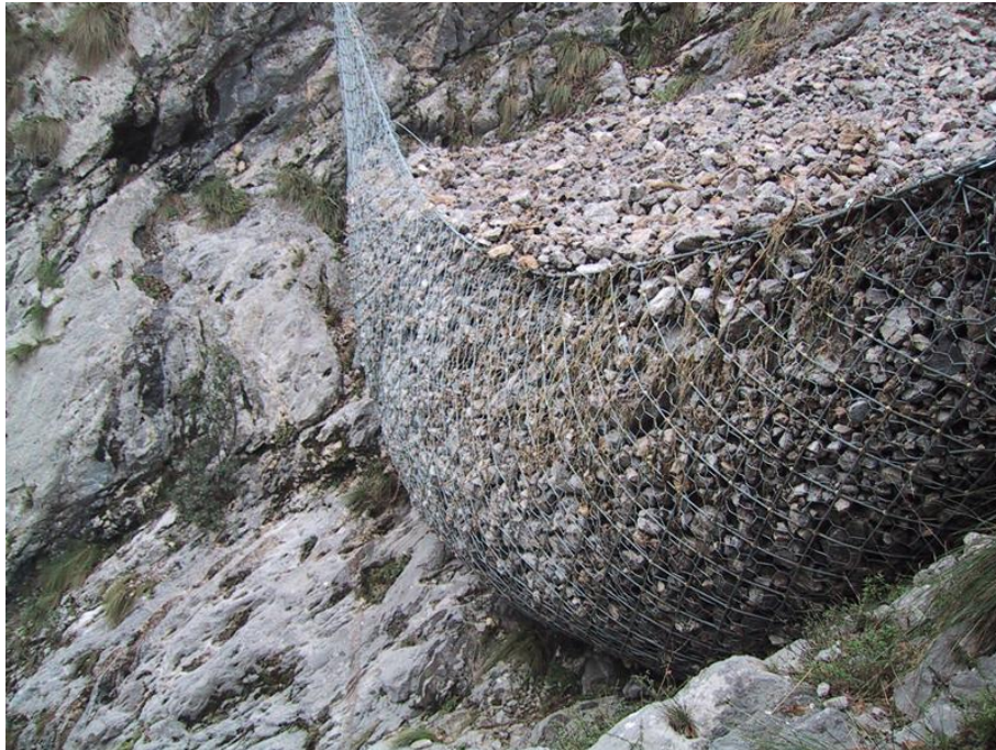
Figura 31 Barreras dinámicas para la protección de taludes
