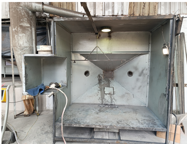
Figura 33. Cabina de aplicación de pintura electroestática en polvo.
