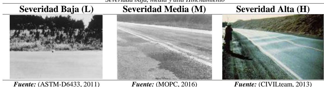
Ilustración 24 Severidad baja, media y alta Hinchamiento
