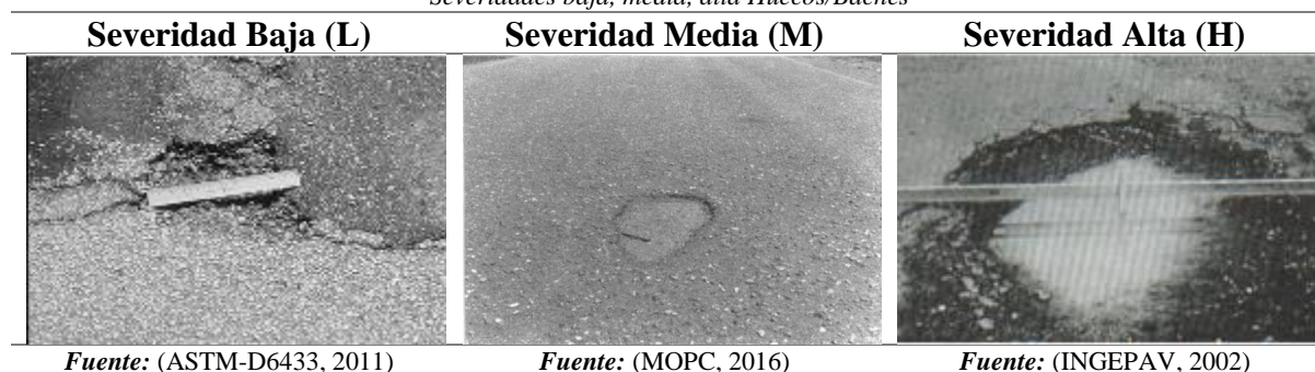
Ilustración 19 Severidades baja, media, alta Huecos/Baches
