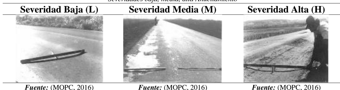
Ilustración 21 Severidades baja, media, alta Ahuellamiento
