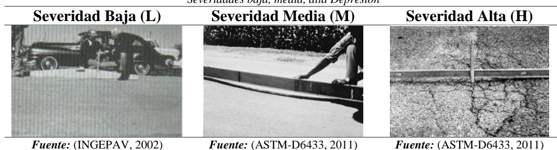
Ilustración 12 Severidades baja, media, alta Depresión
