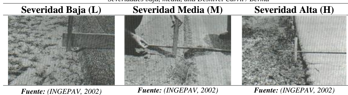
Ilustración 15 Severidades baja, media, alta Desnivel Carril / Berma
