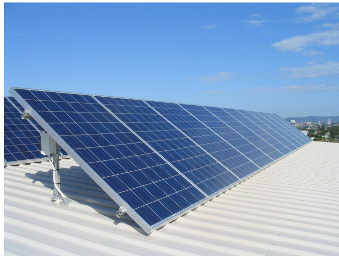
Figura 15: Paneles solares fotovoltaicos
