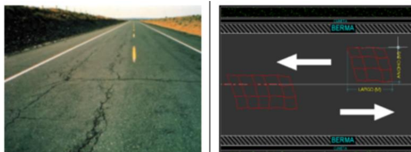
Figura 9. Fisura en bloque
