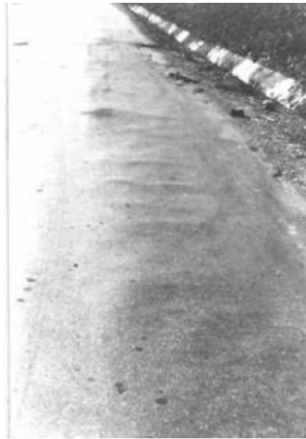
Figura 5. Ondulaciones o corrugaciones de la superficie asfáltica
