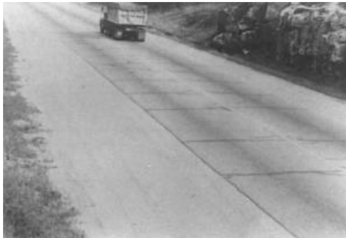
Figura 11. Fisuras por reflexión de juntas
