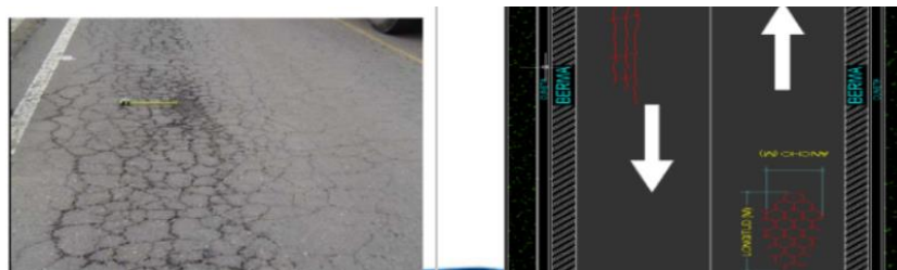
Figura 10. Fisura tipo piel de cocodrilo
