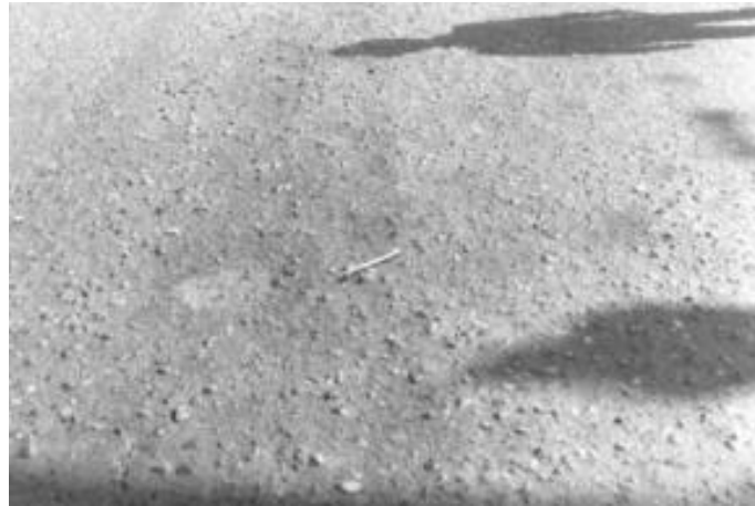
Figura 12. Fisuras por desprendimientos
