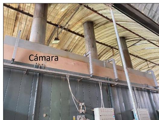
Figura 9. Disposición de la Cámara de recuperación de aire caliente sobre el horno planta Mestiza® S.A.
