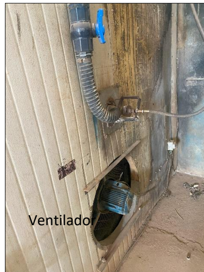
Figura 8. Ubicación de ventiladores de succión temperatura ambiente instalados en la cámara planta Mestiza® S.A.
