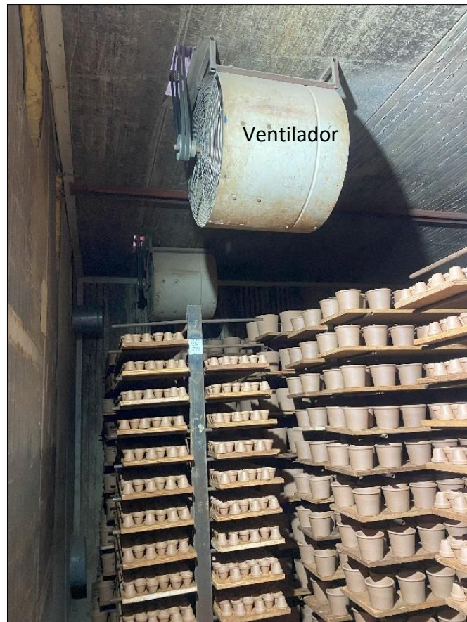
Figura 11. Ubicación ventiladores de recirculación dentro de la cámara 1 de la planta Mestiza® S.A.
