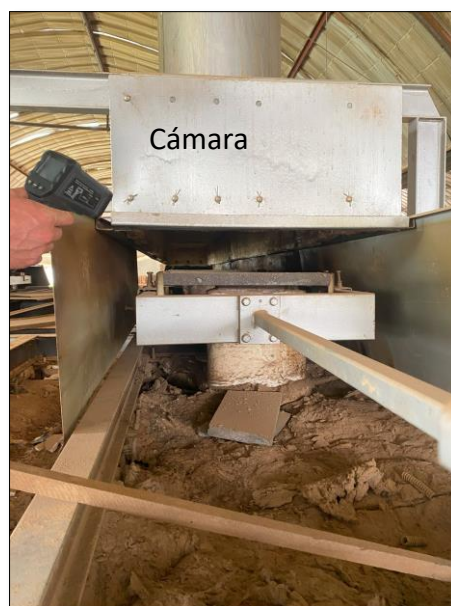
Figura 12. Ubicación cámara de recuperación de gases hacia las chimeneas planta Mestiza® S.A.
