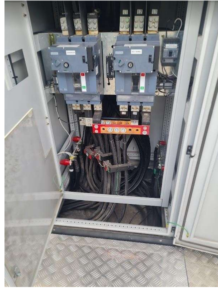
Figura 43. Tablero de transferencia automática 2 Tablero 3b
