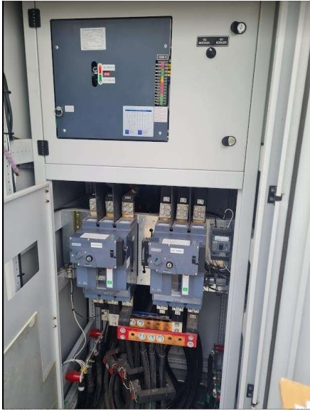
Figura 42. Tablero de transferencia automática 1 Tablero 4b
