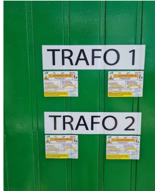
Figura 80. Etiqueta real tablero 6b Trafo 2
