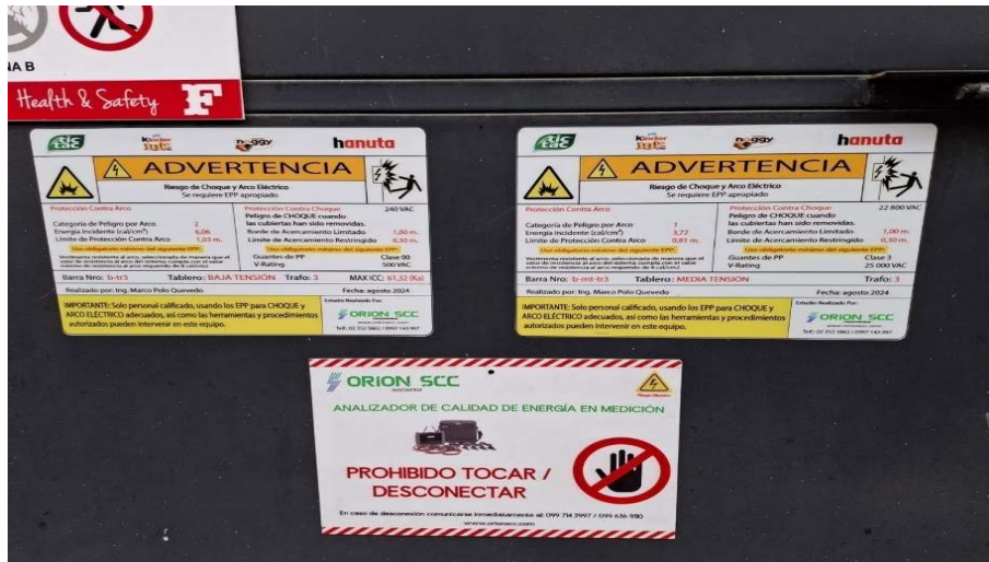
Figura 81. Etiquetas reales cámara de transformación TR3
