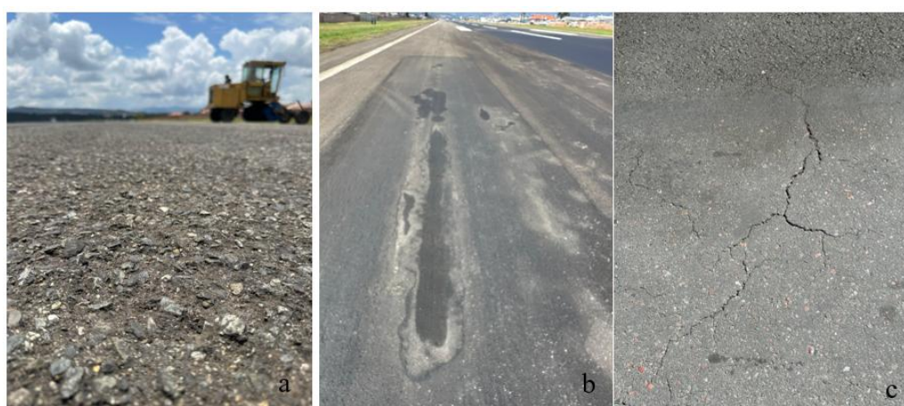
Ilustración 4. Ejemplo de daños severos del pavimento donde no se puede aplicar micropavimento. a) Desprendimiento del pavimento; b) Pavimento con problema de drenaje; c) Superficie con grietas.
