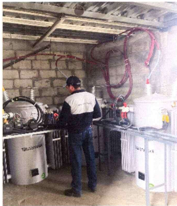
Figura 3.2. Ejecución de mediciones de pruebas
