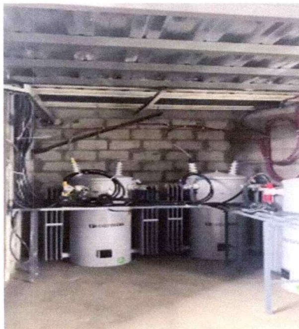
Figura 3.1. Cuarto de transformadores
