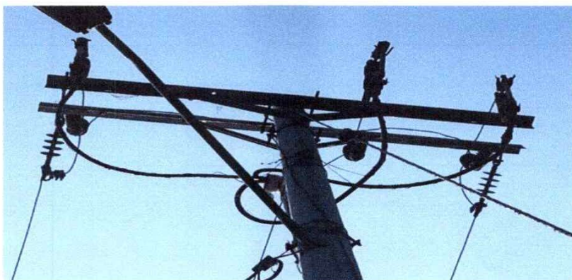
Figura 1.7 Poste con alimentador media tensión
