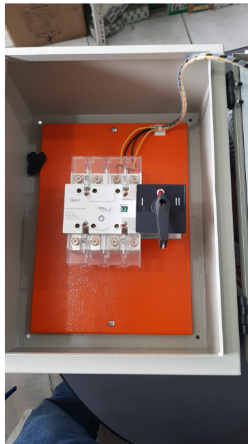
Figura 3.7: Tablero de transferencia
