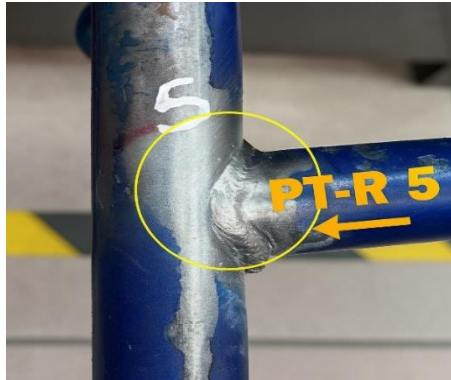
Figura 49.- Junta B-5 (superior) con mordedura detectada mediante PT
