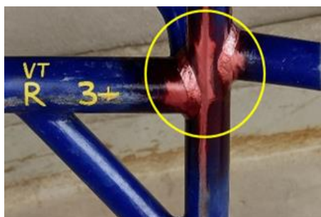
Figura 152.- Detección superficial de microporos en la soldadura
