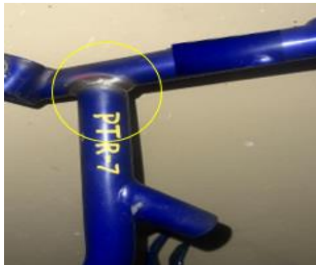
Figura 47.- Junta A-7 (inferior) con poros detectados mediante líquidos penetrantes (PT)
