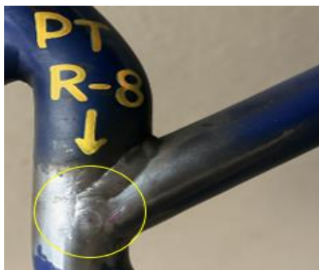
Figura 48.- Junta A-8 (inferior) con indicios de porosidad y falta de fusión detectados
